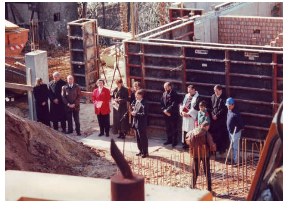
25. März 1998 Grundsteinlegung mit Generalvikar Theodor Stolpe Pfarrer Norbert Sommer und OB Dieter Kmietczyk
